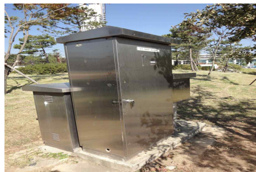
<그림 6.3.2> 지상에 설치된 전원 사례
